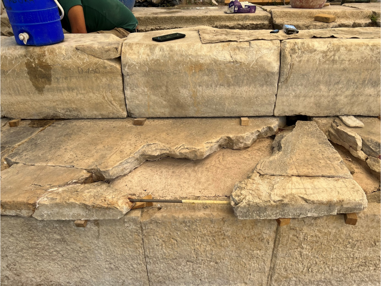
Resim 14: Palmiye Parki. Havuzun kuzey kenarının konservasyonu, parçalanmış iç ayak destek levhasına ait detay (2023).
