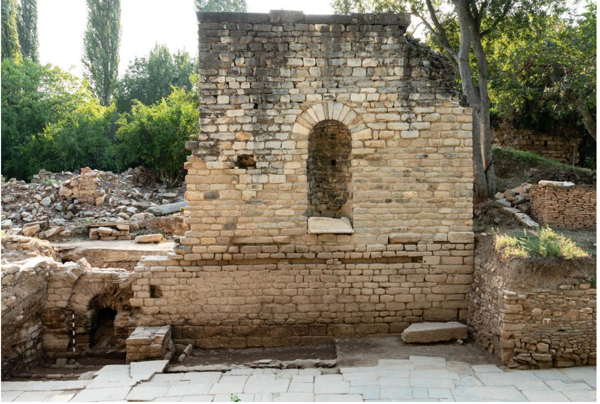
Res. 21: Tetrapylon Caddesi (batıya bakış). Temizlik çalışmaları ve önündeki Nave 18.2 Açmasıındaki kazılar sonrası görünüm (2018).
