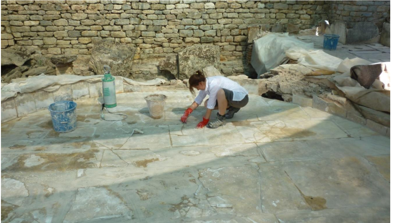
Res. 6-7: Hadrian Hamamı. Oda 12: genel görünüm (üst resim) ve dairesel sıcak havuzun hasar görmüş mermer tabanı üzerindeki çalışma (alttaki resim, 2014).
